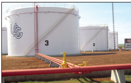
Sistema de proteção instalado nos tanques de etanol
