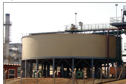
Foto 2. Tanque de separação gravimétrica (sedimentação) material sólido em águas residuais.
